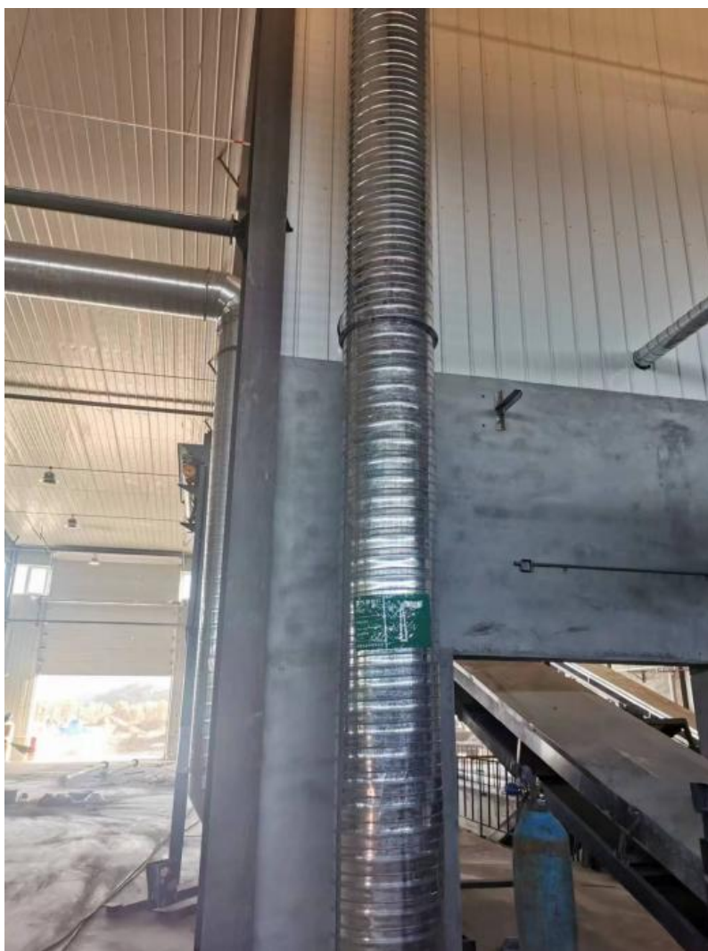
1#排气筒/储存、进料、粉碎、筛分废气排放口 (DA001)
