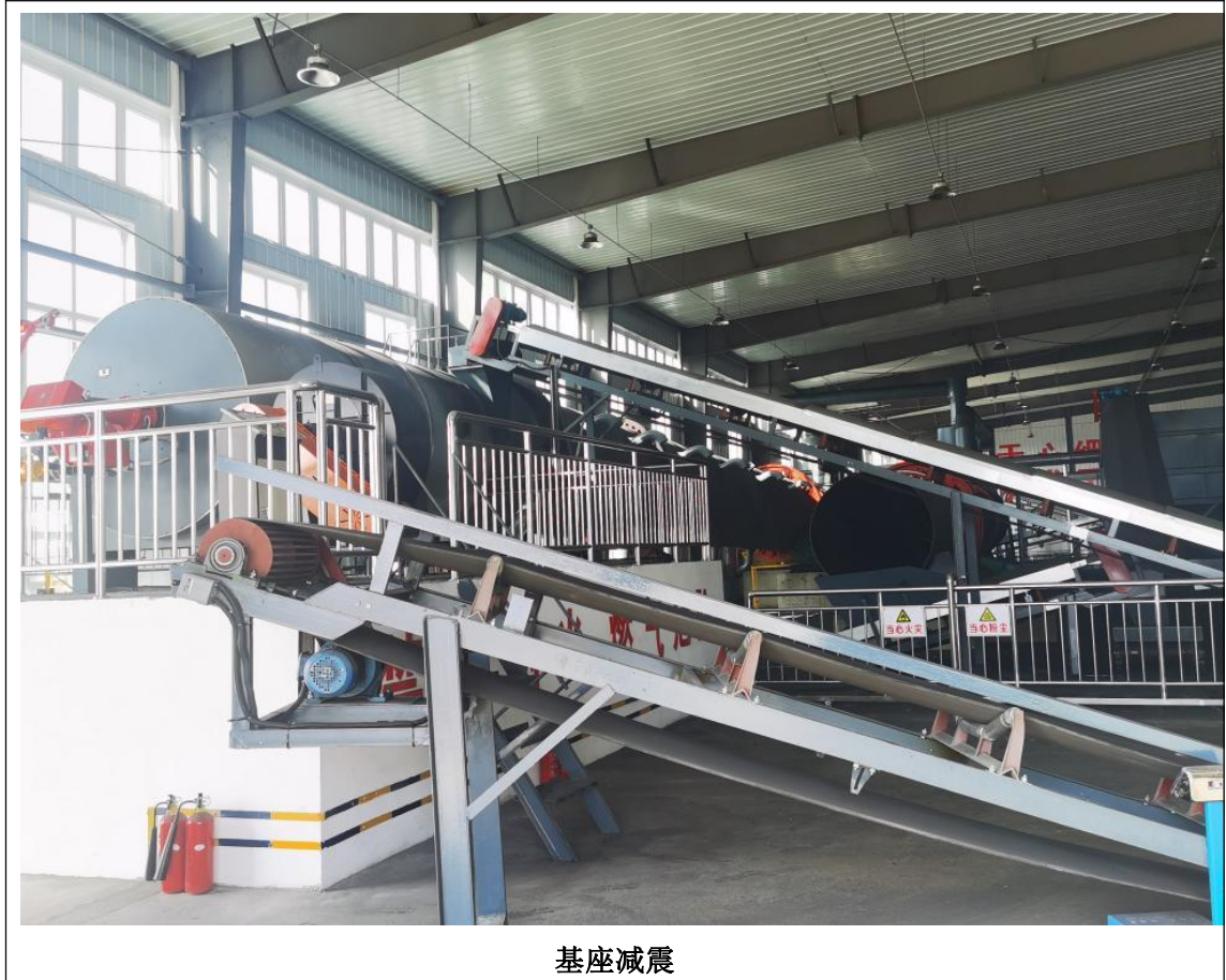
图 3-3 噪声防治设施现场照片
